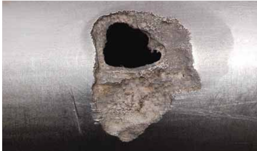
Abb. 6.7: Durchrosten eines unterirdischen Rohrs aus nichtrostendem Stahl der Sorte 4404 aufgrund eines zu geringen Abstands zu einer unterirdischen, stromführenden Leitung. Dadurch war der Stahl nicht länger im idealen passiven Bereich, sondern im „transpassiven“, in dem eine Korrosion möglich ist. Deutlich ist auch das Fehlen von Lochfraß zu erkennen.
