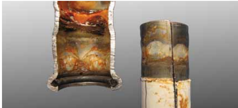
Abb. 6.21: Spaltkorrosion in Pressfitting (links) und Rohren (rechts) aus 4404 infolge Bakterienvermehrung in einer Trinkwasseranlage. Die Korrosion entstand in 45-50 °C warmem Wasser mit weniger als 100 ppm Chlorid. Wie klar in der Aufnahme zu erkennen, begann die Korrosionen, die hellgrauen Bereiche rechts, an den engsten Stellen, wo die Muffe fest auf das Rohr aufgespresst war.
