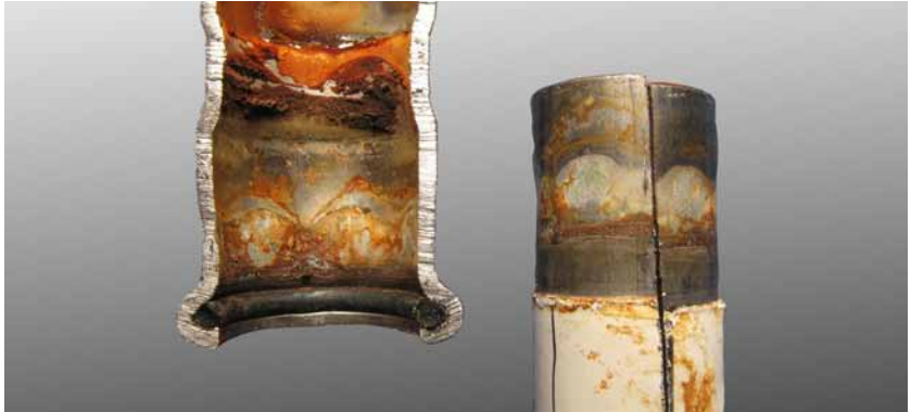
Figur 6.21: Spaltekorrosion i pressfittings (t.v.) og rør (t.h.) af 4404 som følge af bakterievækster i drikkevandsinstallation. Korrosionen er opstået i 45-50 °C vand med under 100 ppm klorid, og det bemærkes, at korrosionen (de lysegrå områder til højre) har taget fat på de snævraste steder, hvor muffen er klemt sammen om røret.
