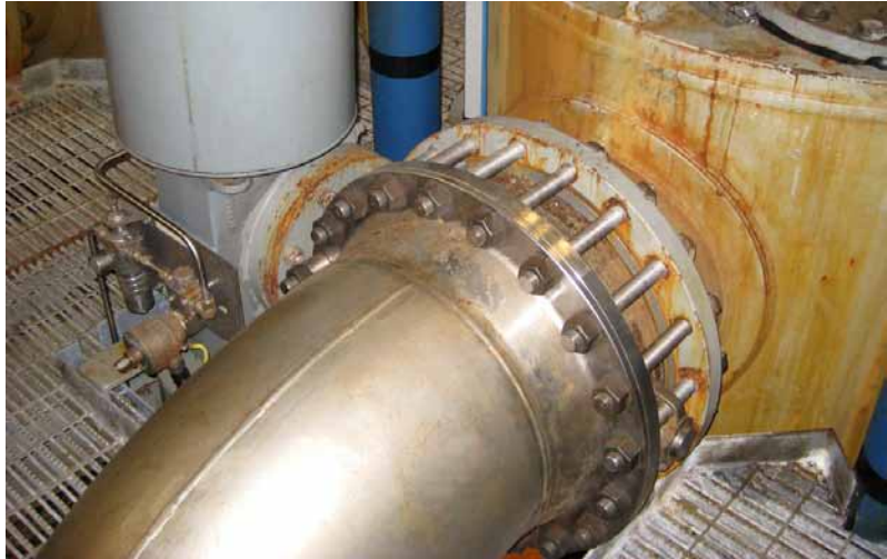
Figur 6.22: Havvand er et af de mest korrosive miljøer over for rustfrit stål. Risikoen er især spaltekorrosion, og skal det undgås, bliver man nødt til at anvende "superlegeringer". Dette kølevandssystem fra en boreplatform på den danske del af Nordsøen er fremstillet af 4547 (254 SMO). Foto: © Maersk Oil.
